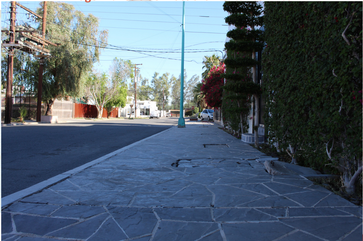
Imagen 4. Acera del Fraccionamiento Los Pinos
