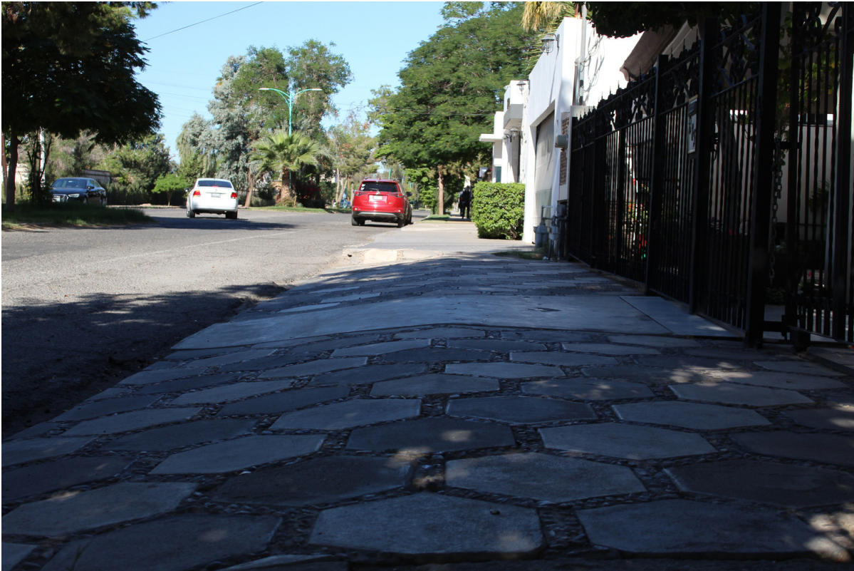
Imagen 1. Acera del Fraccionamiento Los Pinos
