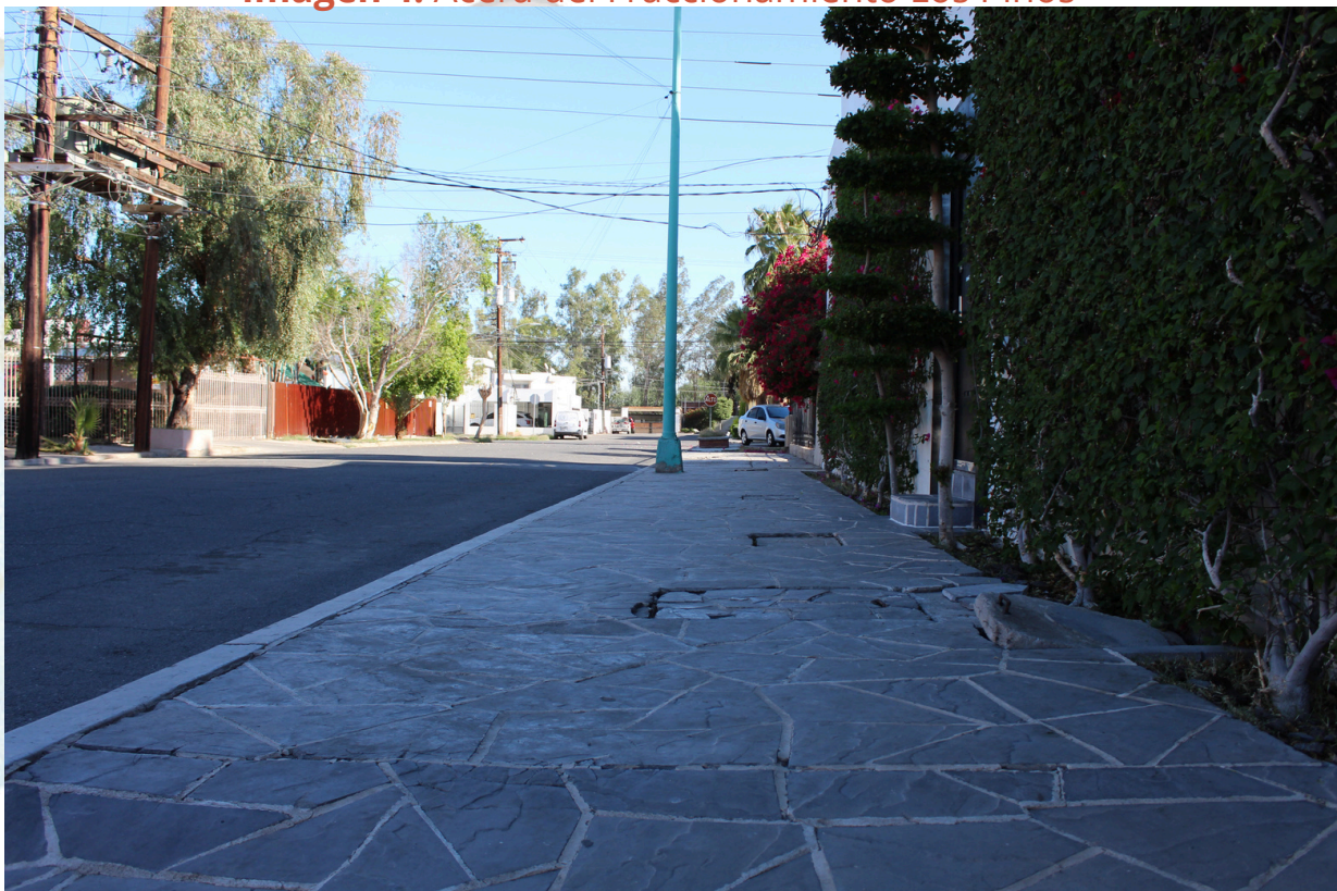
Imagen 4. Acera del Fraccionamiento Los Pinos
